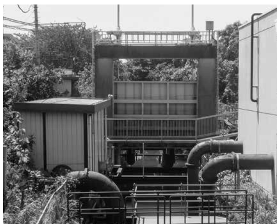
△西新宿地区第一排水機場
