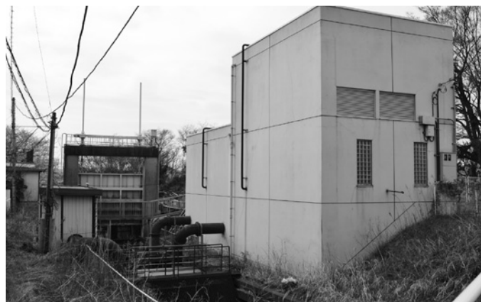
西新宿地区第一排水機場
