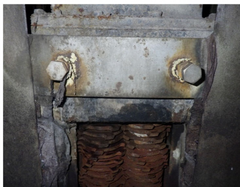
確認部品：ケーシング 状況：腐食が見られる
