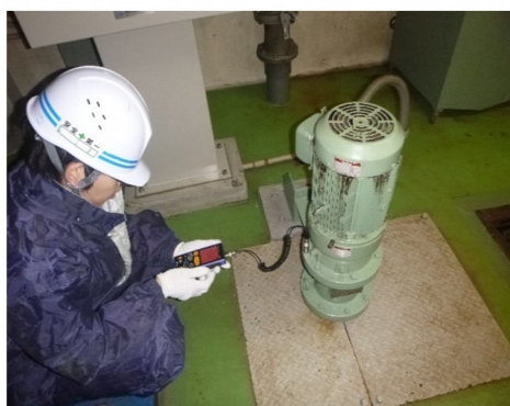
確認部品：減速機付き電動機 状況：振動測定状況
