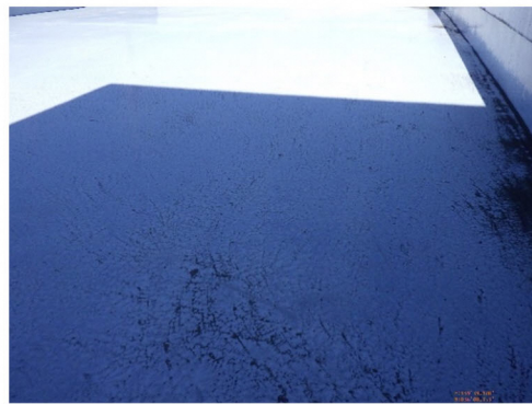
確認部品：屋根防水_屋上部 状況：全体的に摩耗が進行している
