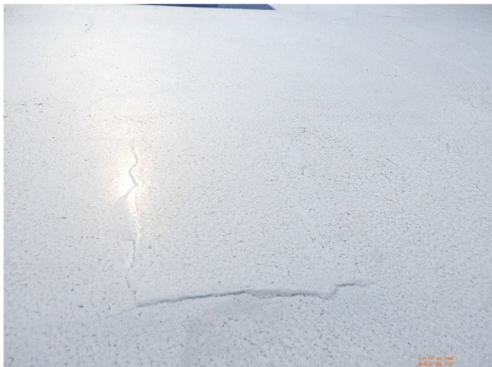
確認部品：屋根防水_屋上部 状況：一部に浮きが見られる
