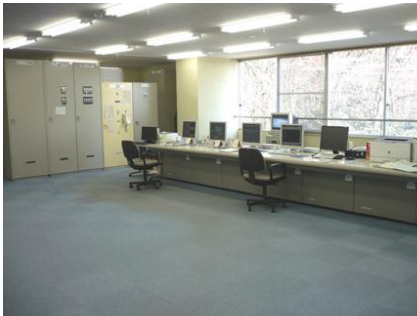
浄水場、黒浜配水池場を管理するコントロール室
