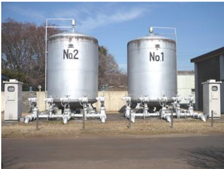
地下水に含まれる、鉄やマンガン等を取除く、急速ろ過機
