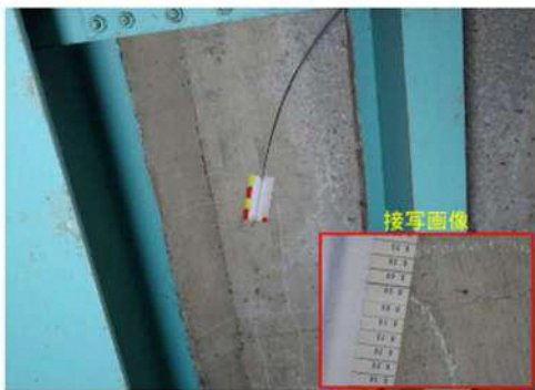
写真-3 床版(ひびわれ)
