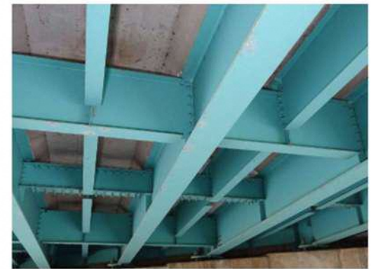
写真-4 主桁(腐食)
