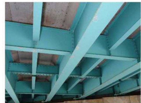
写真-4 主桁(腐食)
