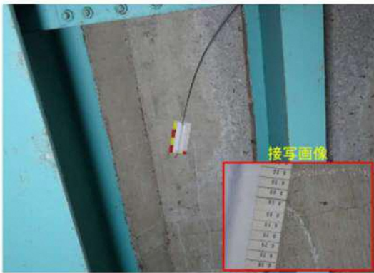
写真-3 床版(ひびわれ)
