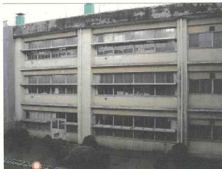
外装材の著しい劣化
