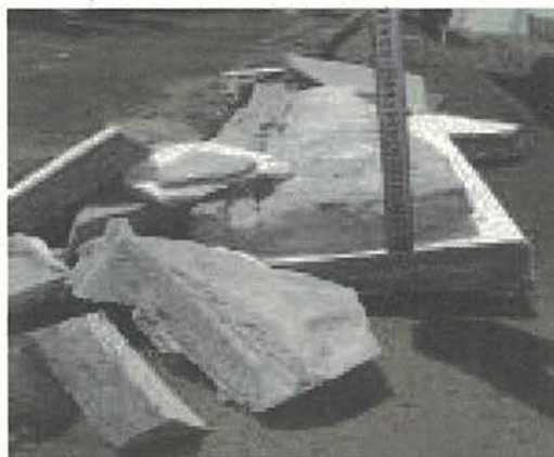
モルタルの剥離落下
