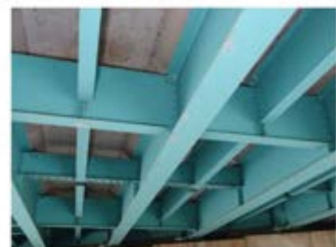
写真-4 主桁(腐食)
