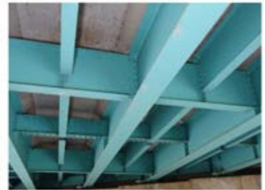
写真-4 主桁(腐食)
