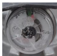
× 指示圧力計の損傷
