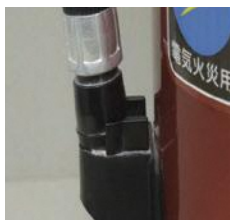
× 消火薬剤の漏れ
